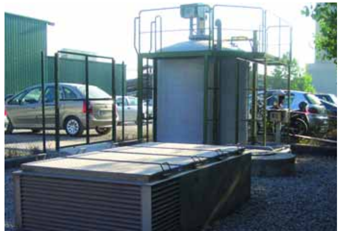
Nova depuradora d'aigües residuals
